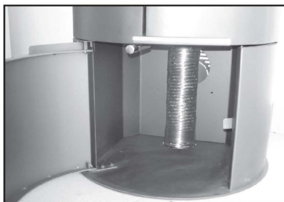
Uteluftsslangen bör kondensisoleras
